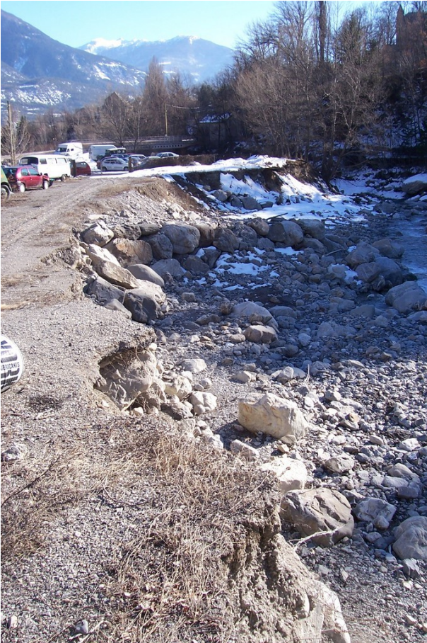
Illustration 17: Crue du Rabioux du 24/10/2006, érosion de la rive gauche au niveau du garage
