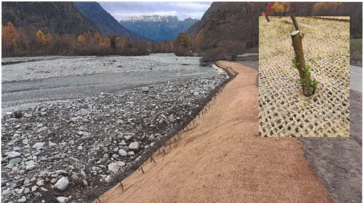
Figure 1: vue l'ouvrage en génie mixte réalisé sur la Séveraisse à l'automne 2022, et photo d'une des boutures de l'ouvrage en cours de reprise (le 12/04/23)
